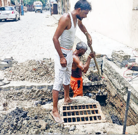
उचाना। पुरानी मंडी में ड्रेन के मैनहॉल के पास सफाई करते हुए। फोटो: हरिभूमि
